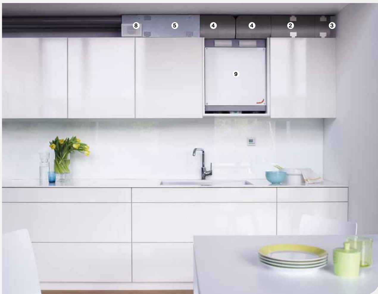
Instalace v kuchyni - odkrytá
